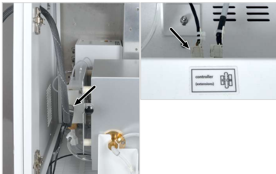
Fig. 42 Raccord de la conduite de transfert de gaz dans le module de base
